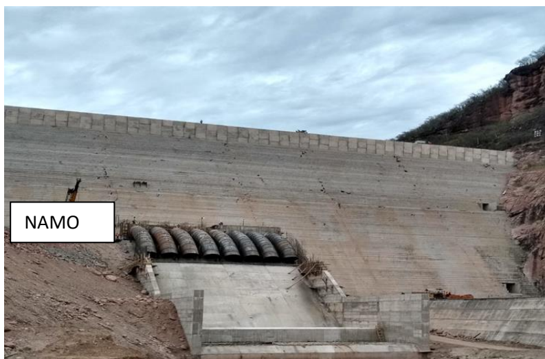
Ilustración 2 Fotografía que muestra los 8 tubos de descarga rápida del NAMO
